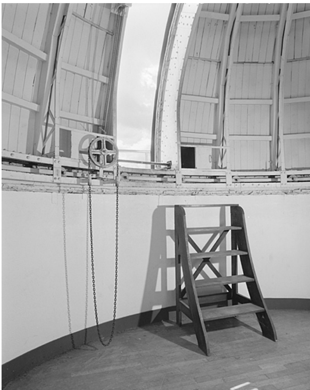
Vue d'ensemble du système d'ouverture du dôme.
