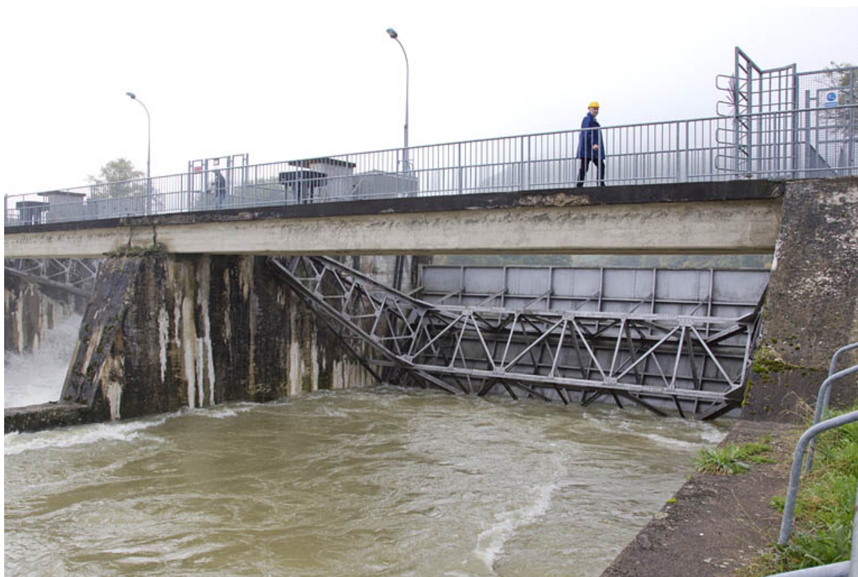
Vanne segment depuis l'aval.
