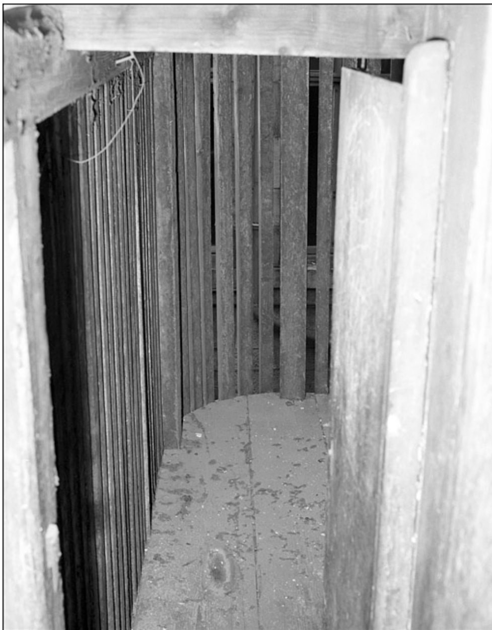
Détail de l'intérieur du bûcher.
