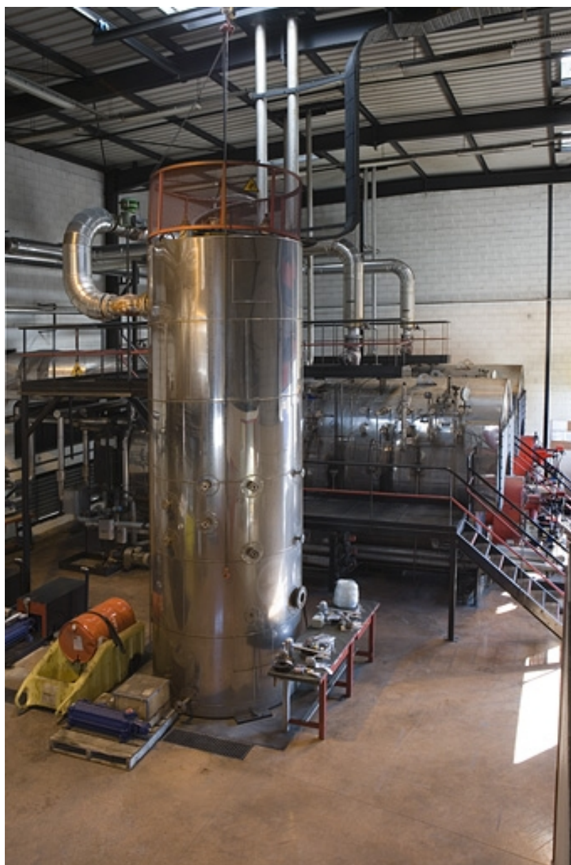
Chaufferie. Vue intérieure.
