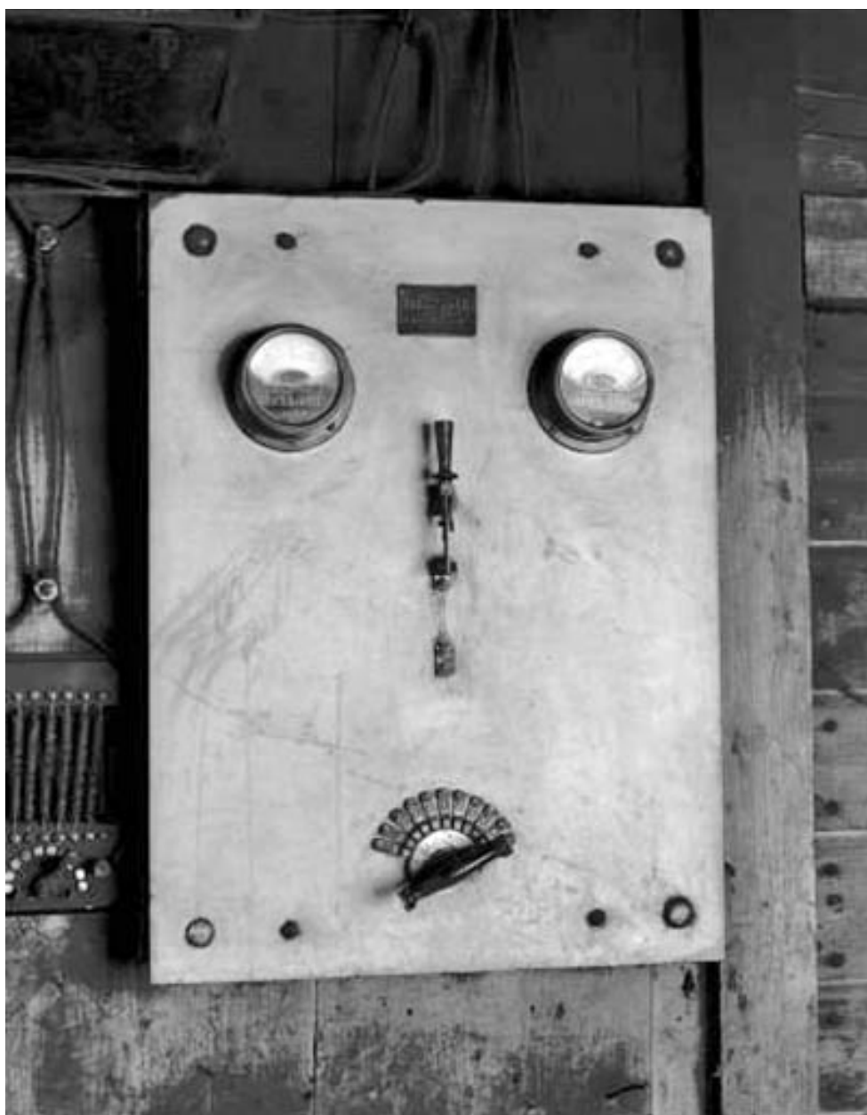
Intérieur : tableau de contrôle Grauer et Weil.
