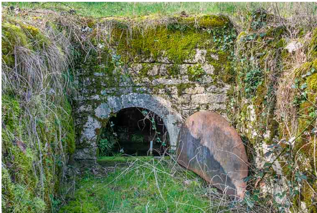
Captage de la source.
