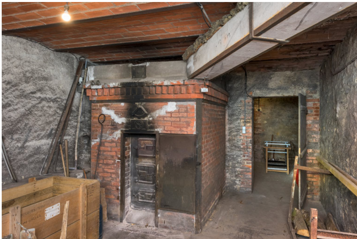
Calorifère au sous-sol.
