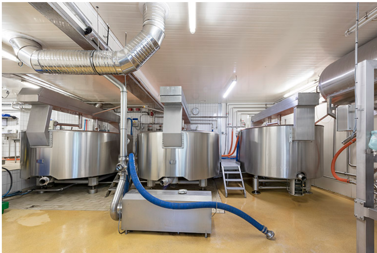
Intérieur de l'atelier de fabrication : les cuves.
