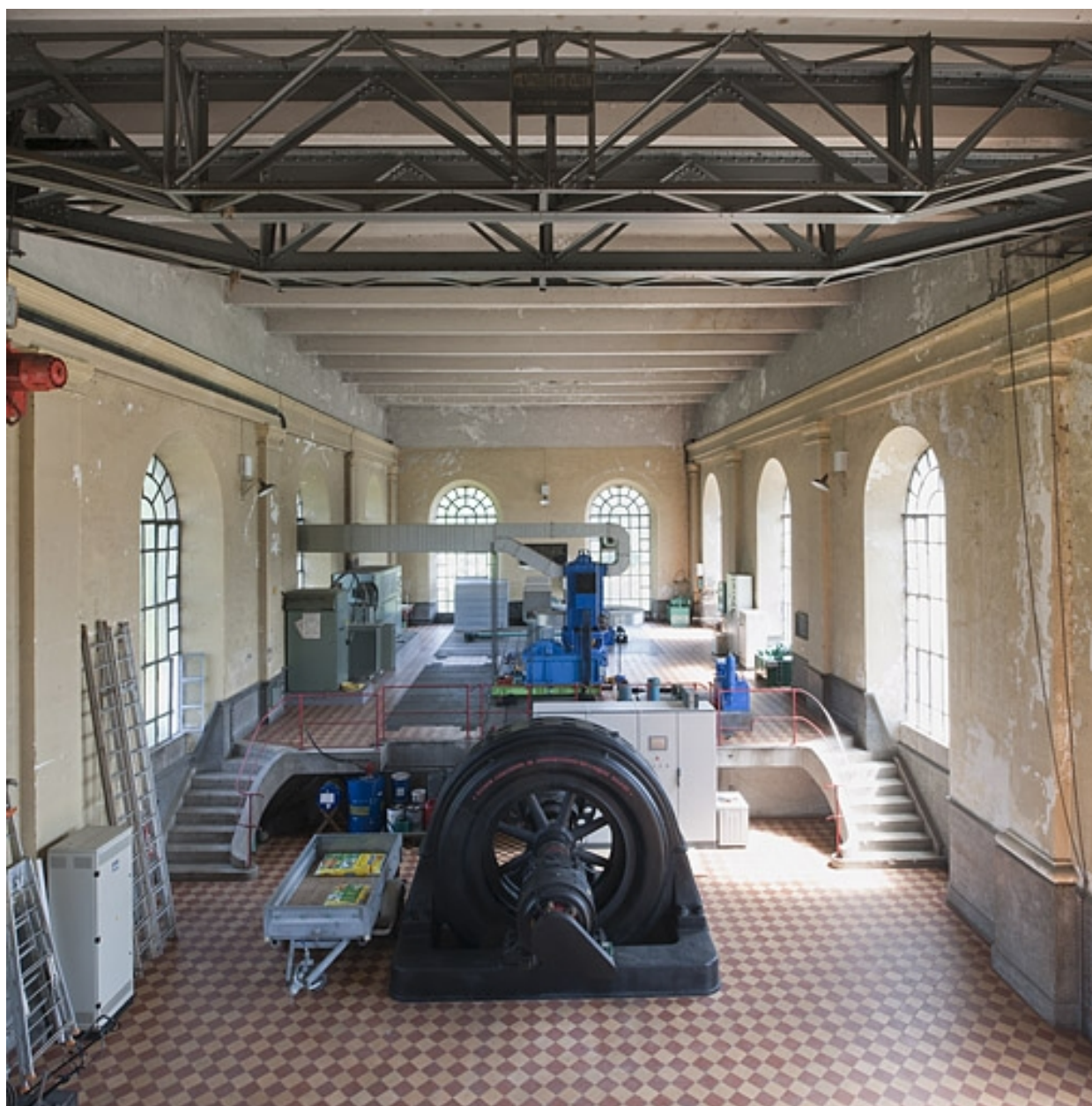
Salle de la centrale hydroélectrique de Mathay.
