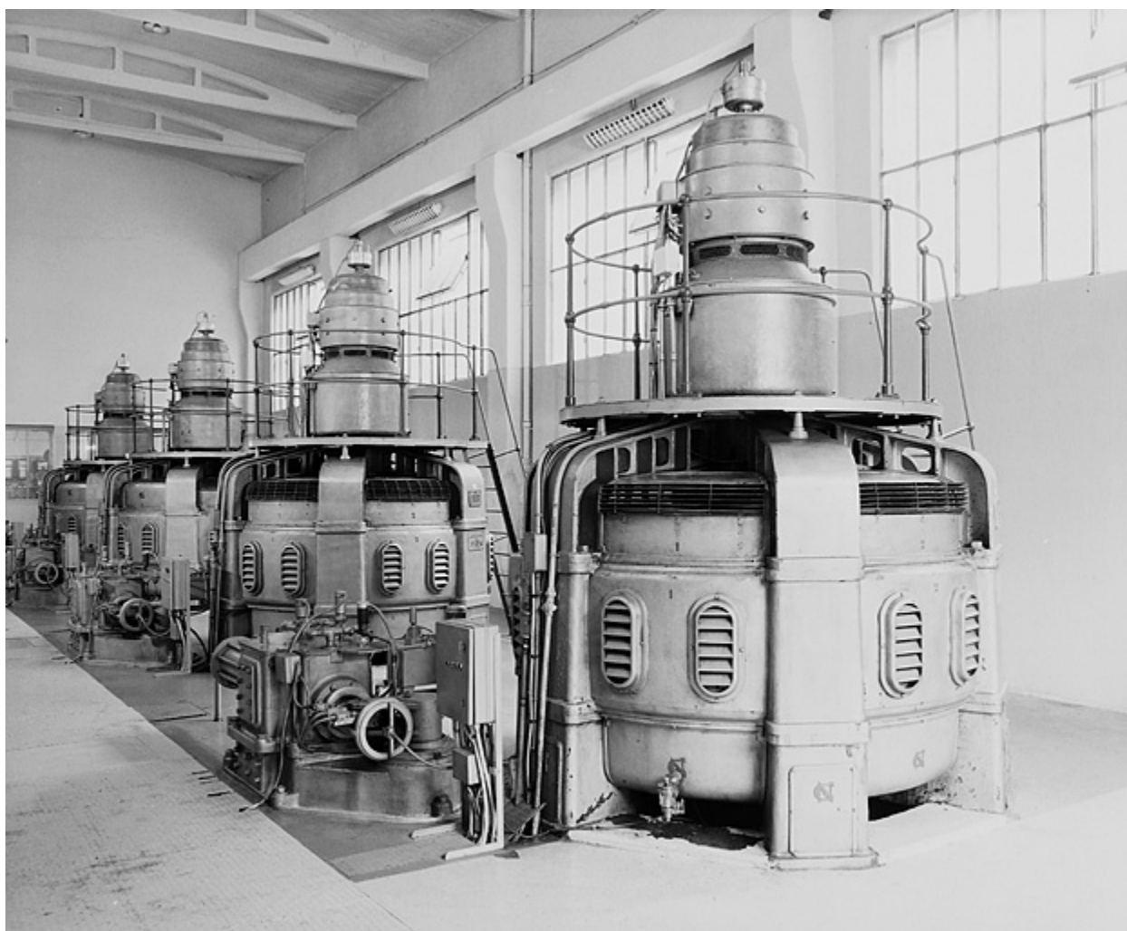
Vue d'ensemble des alternateurs.
