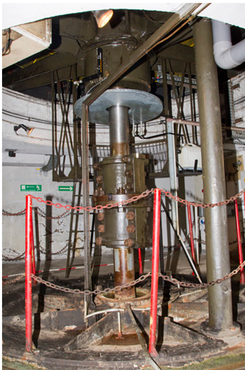
Détail de la transmission verticale d'une turbine.
