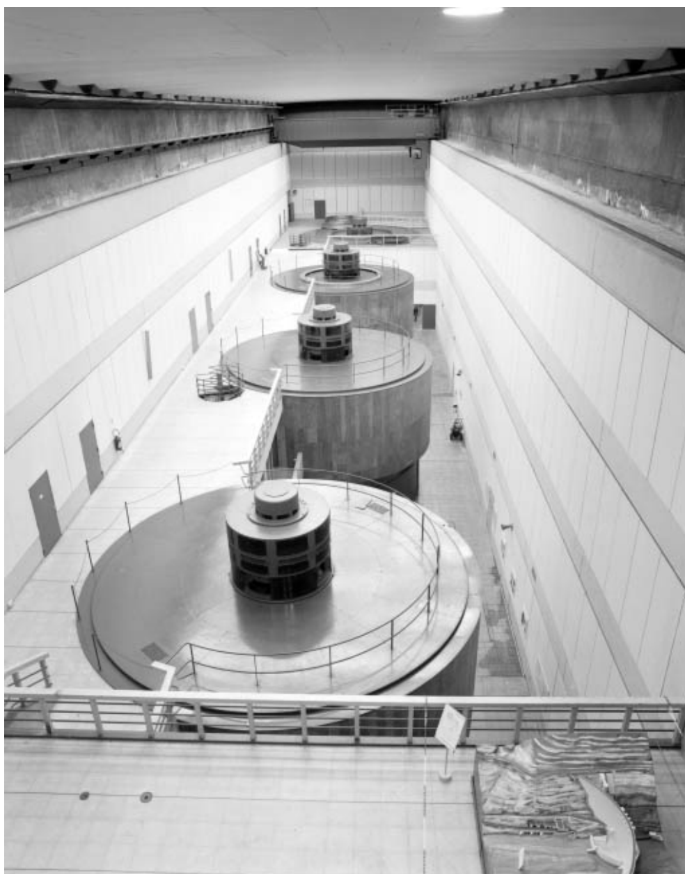
Vue d'ensemble de la salle des machines.
