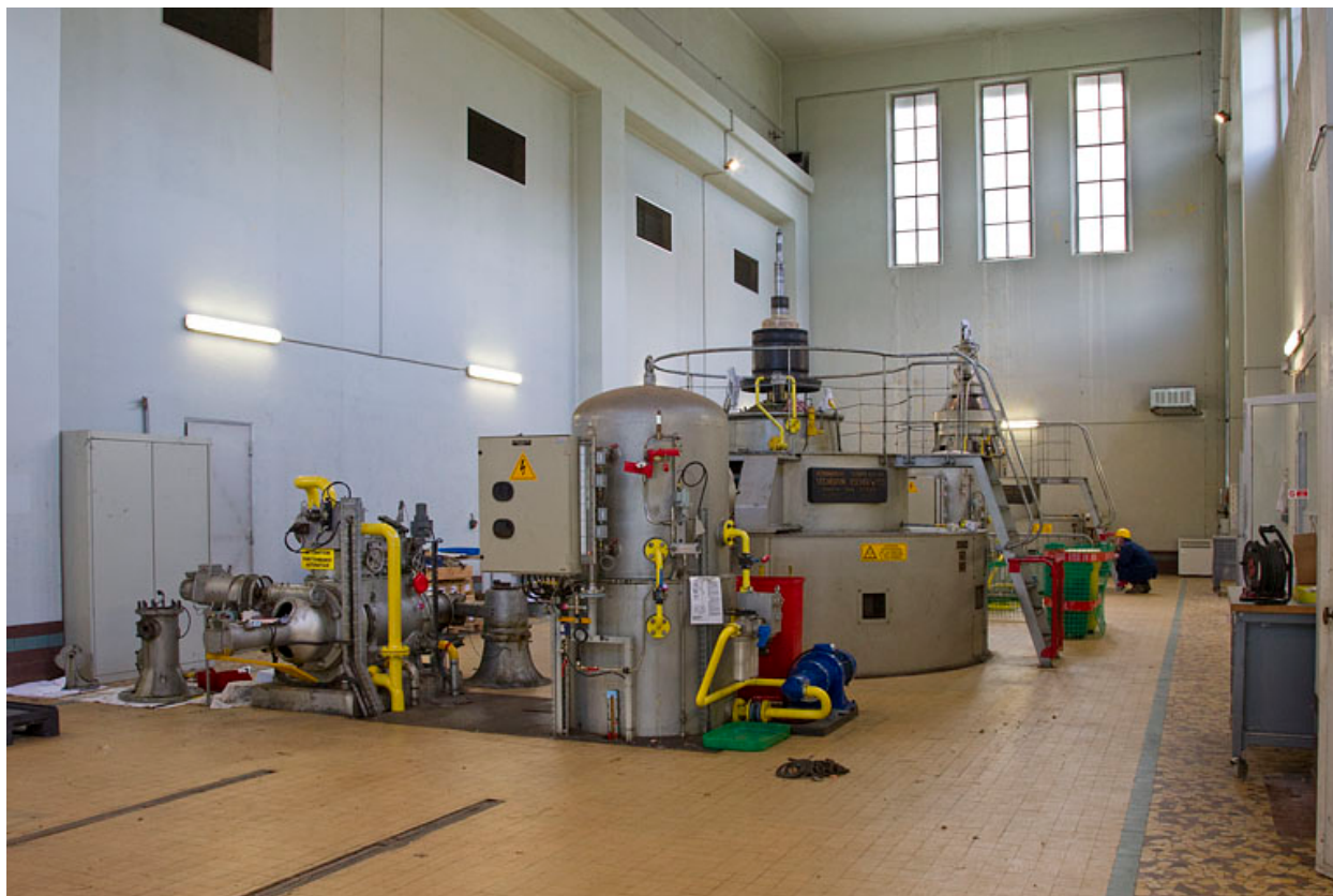
Centrale de Valfrey : intérieur de la salle des machines.
