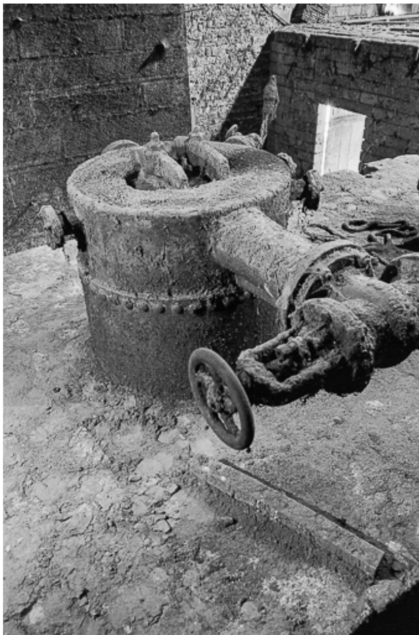
Partie supérieure de la chaudière. Vannage.
