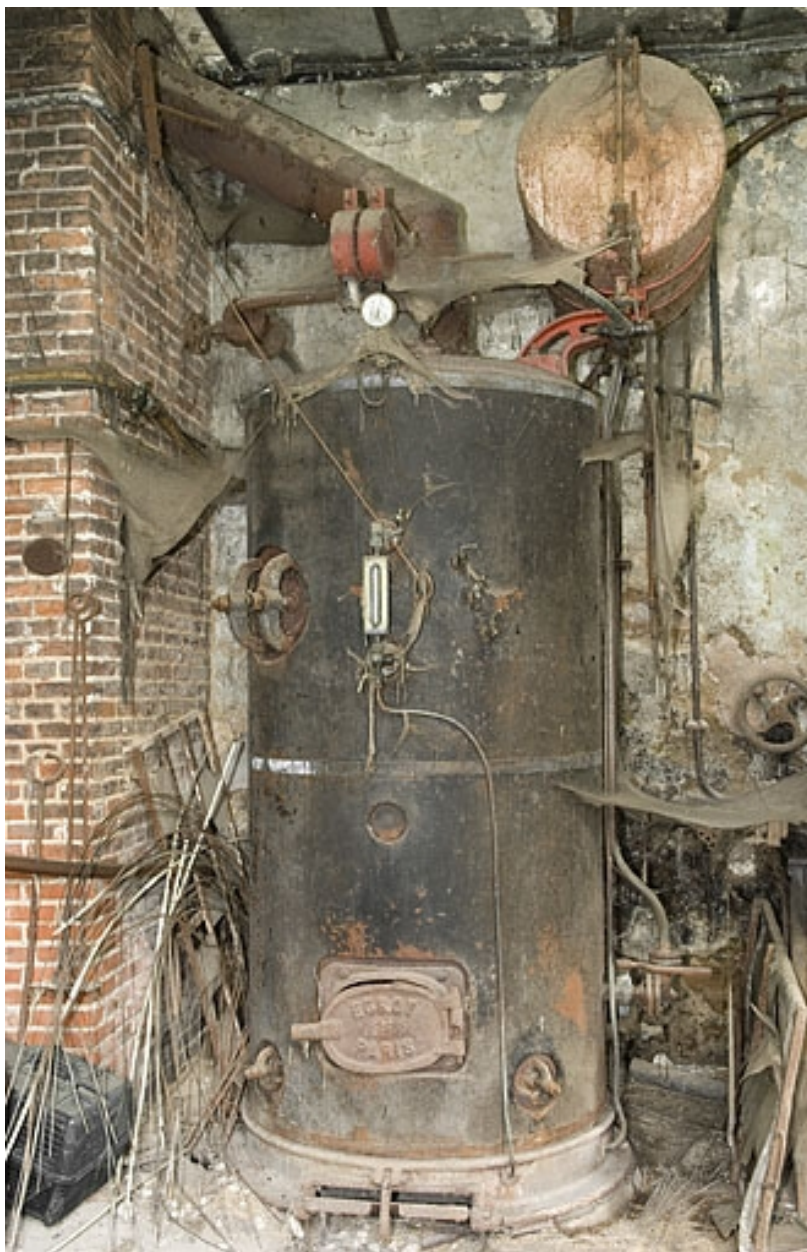
Atelier de distillation. Chaudière Egrot.
