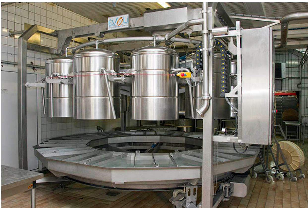
Groupe de soutirage.
