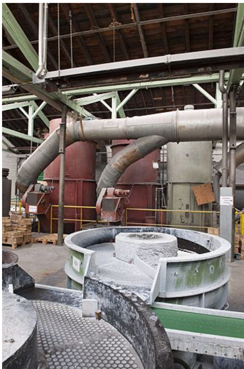
Atelier de polissage et chambre d'aspiration.
