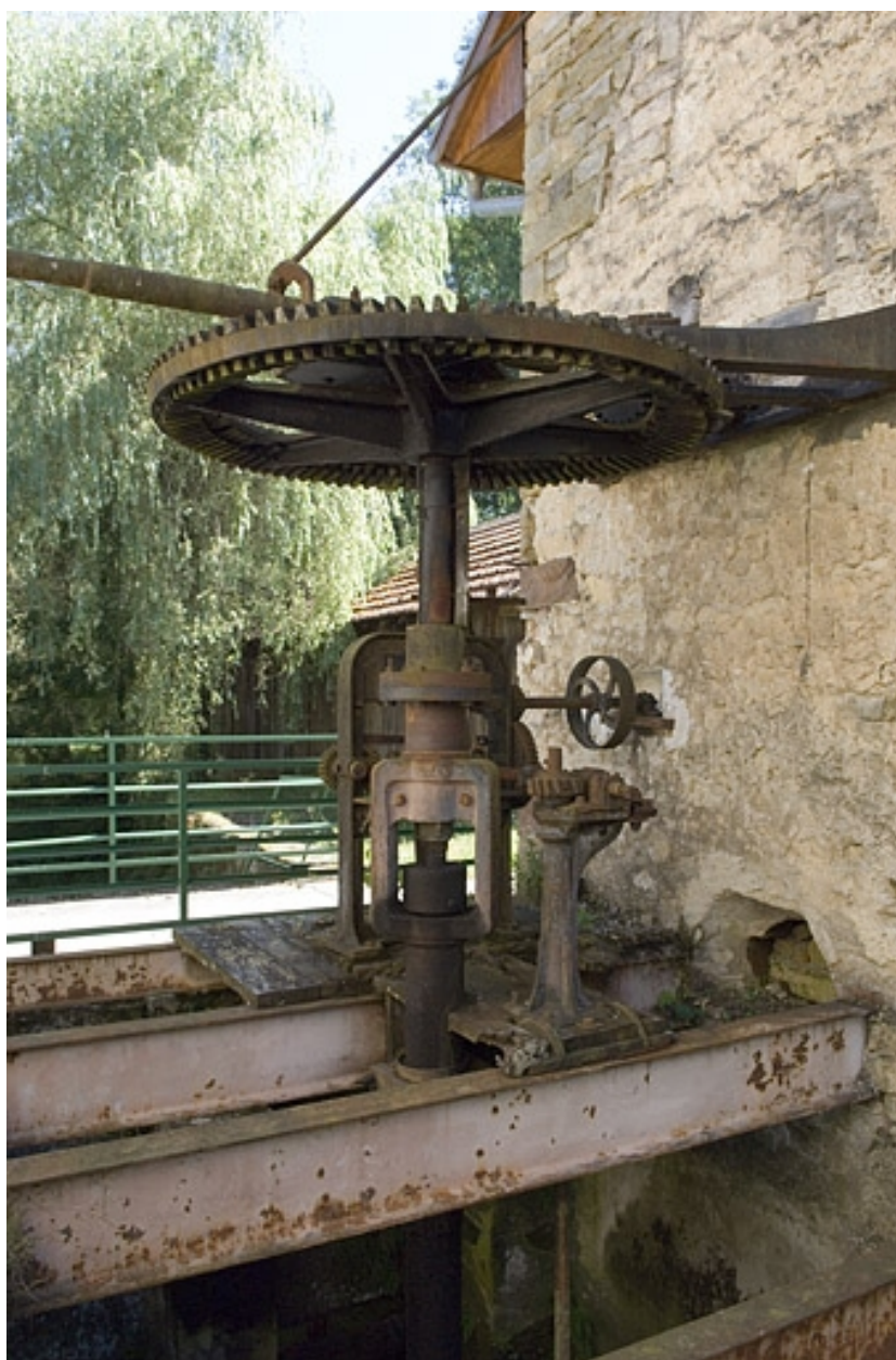
Turbine hydraulique. Partie supérieure de la transmission.
