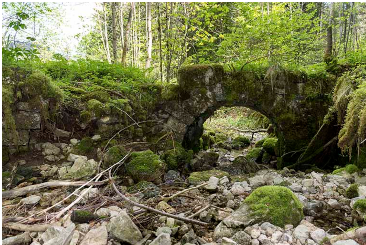
Pont en ruine.
