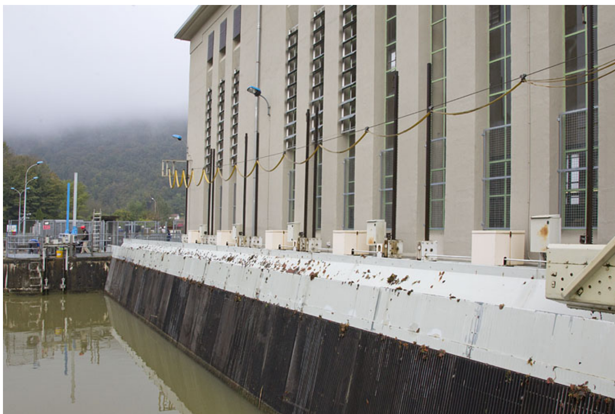
Grille d'admission de la centrale.
