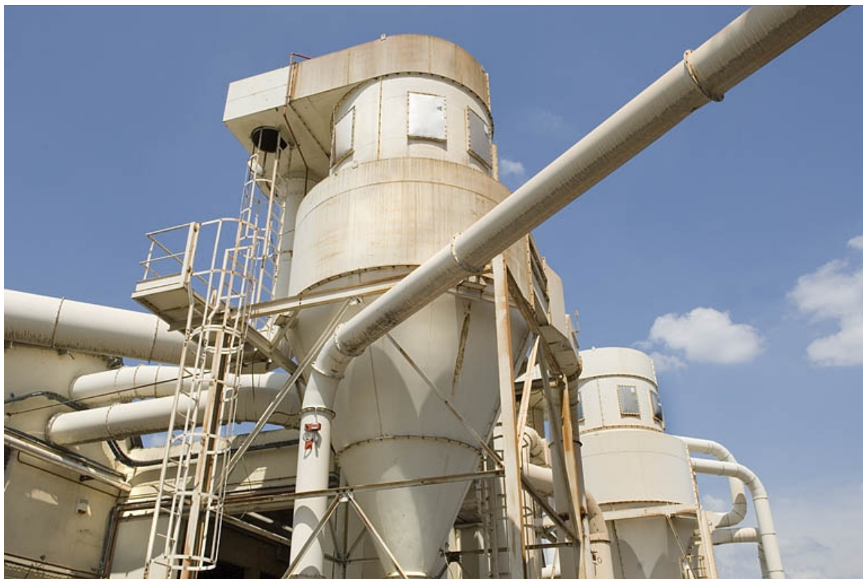
Silos de sciure.
