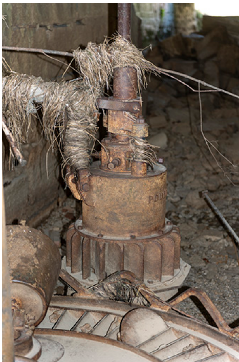
Moulin : transmission de la commande d'admission d'eau.
