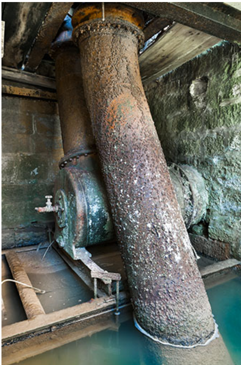
Turbine hydraulique (partie inférieure).
