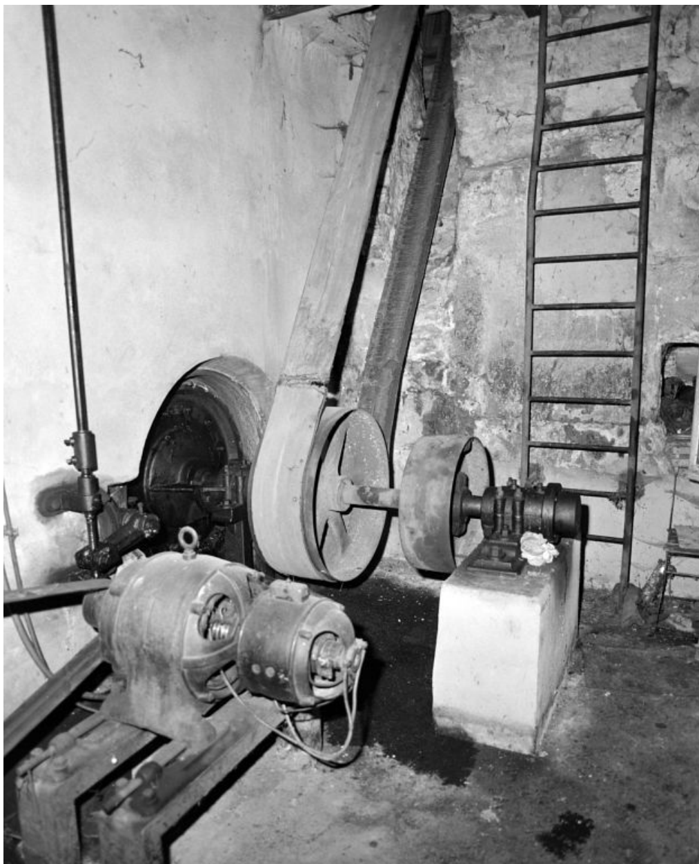
Etage de soubassement. Turbine et générateurs.
