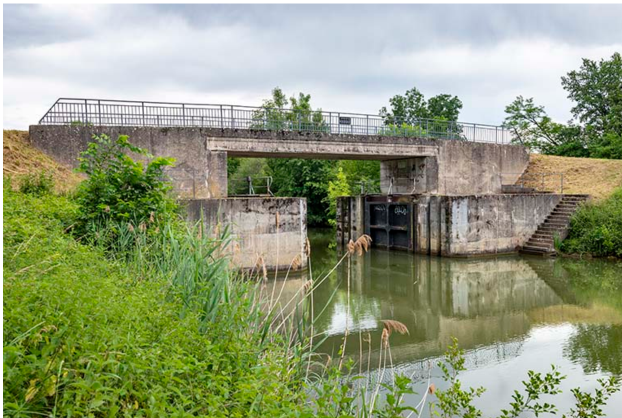
Vue aval de la porte de garde.
