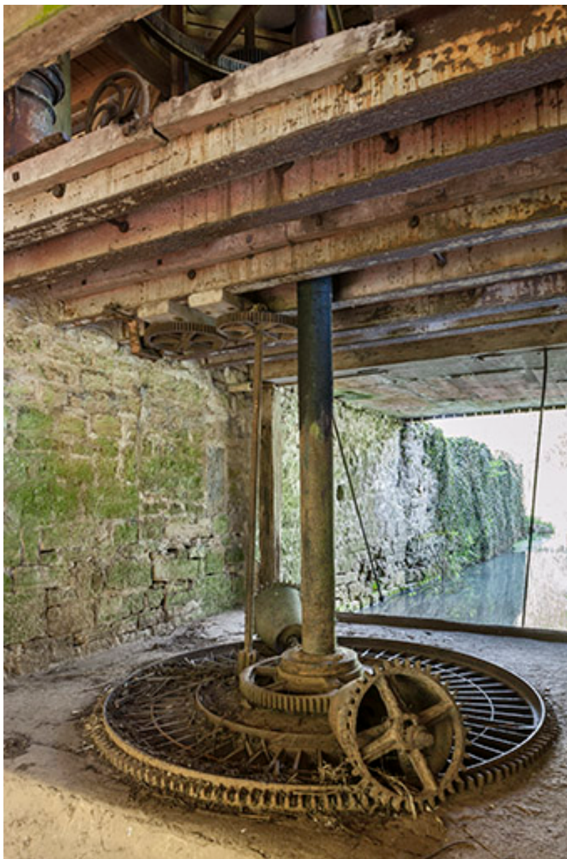
Partie supérieure de la turbine.
