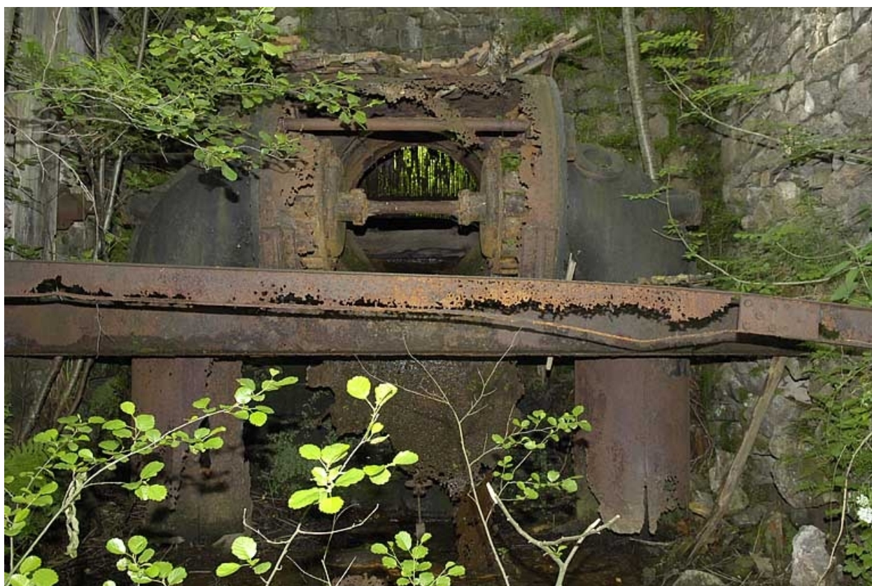
Turbine hydraulique à axe horizontal. Vue rapprochée.
