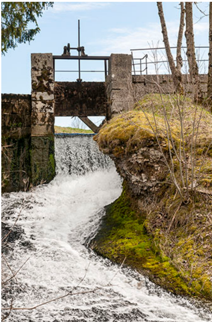
Vanne de décharge sur le Bief Rouge.
