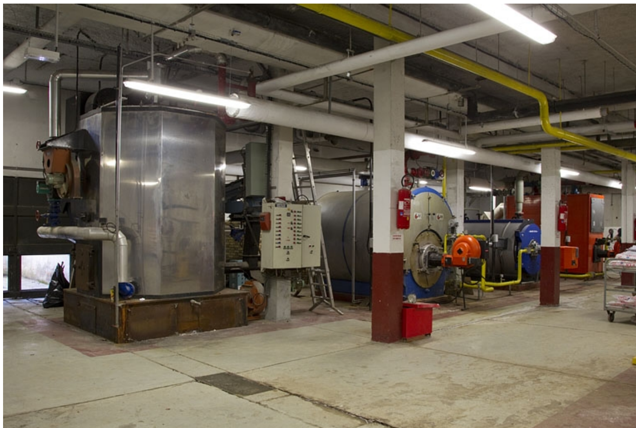
Bâtiment de l'internat ouest, chaufferie : les chaudières.
