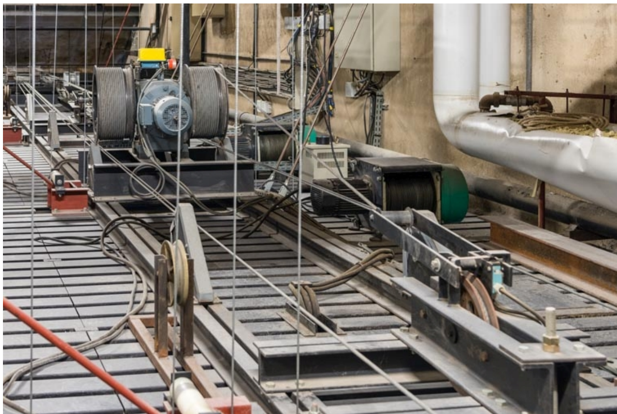
Cintre : moteur électrique d'une équipe (cadrage horizontal).
