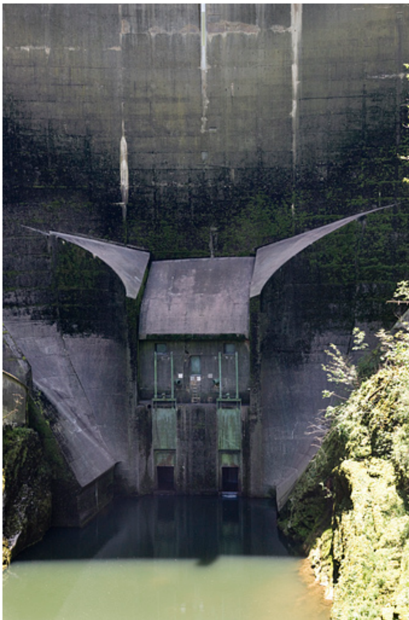
Barrage du Châtelot : vannes de fond.
