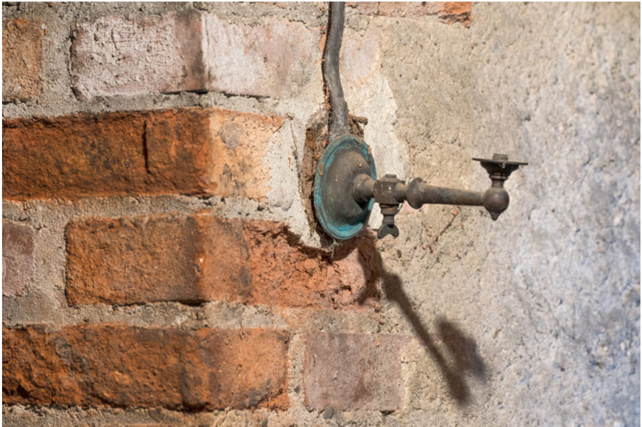
Luminaire d'applique au sous-sol.
