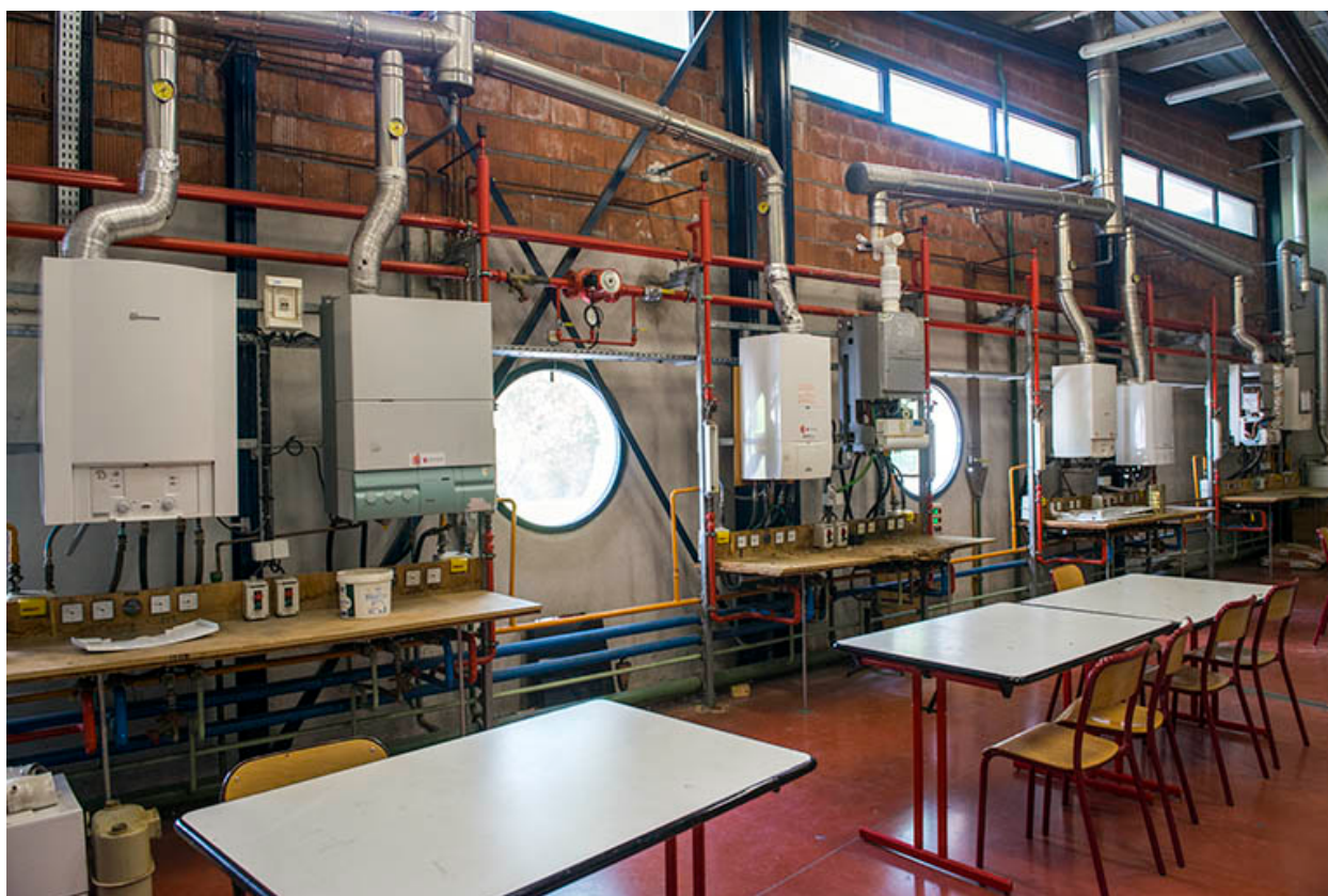
Vue intérieure des ateliers du pôle énergie.
