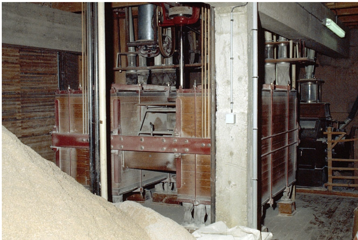
Minoterie (H), rez-de-chaussée : plansichter.
