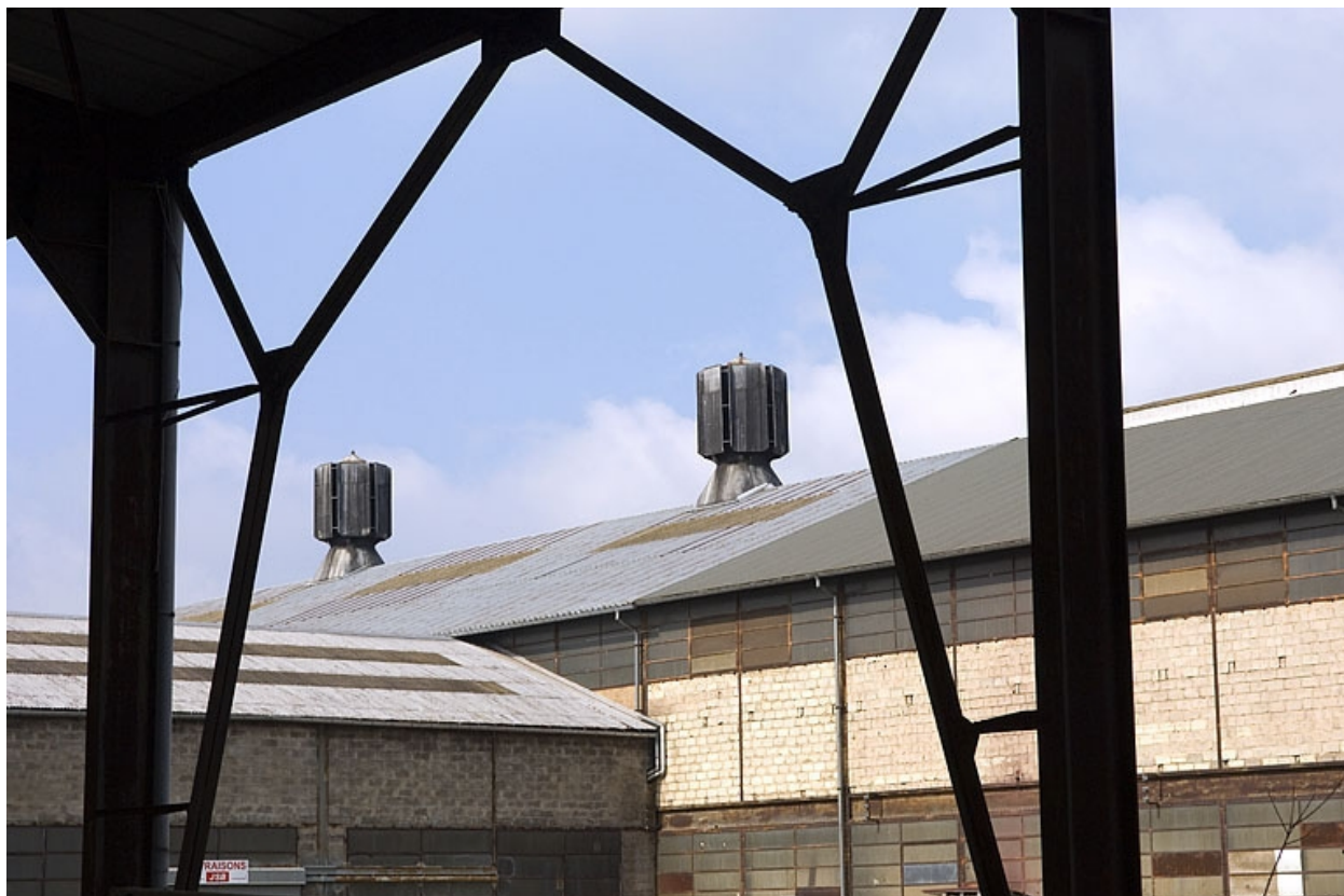
Atelier de fabrication. Cheminées d'extraction.
