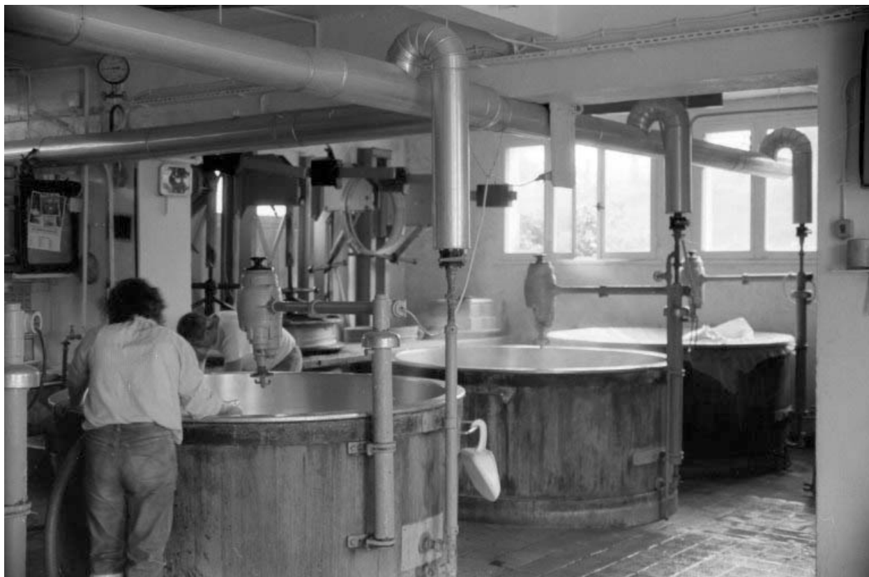
Atelier de fabrication : les cuves.
