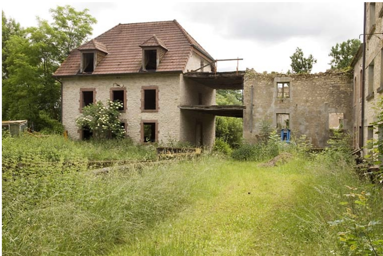
Logement et bâtiment en ruine.
