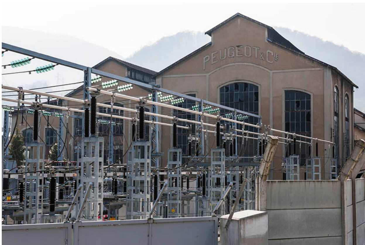
La centrale thermique.
