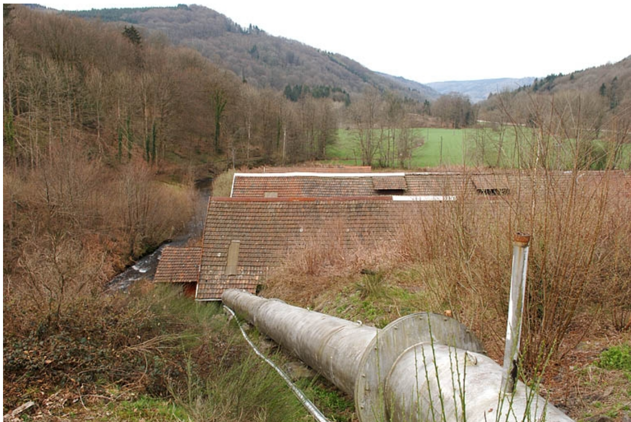
Conduite forcée de la centrale hydroélectrique.
