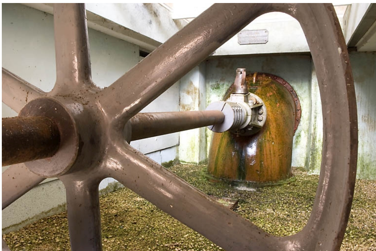
Usine : axe de transmission et volant.
