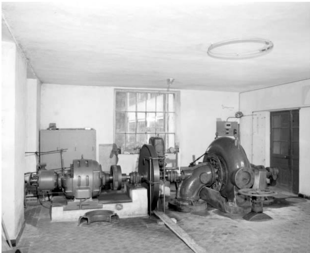
Centrale hydroélectrique : groupe récent.
