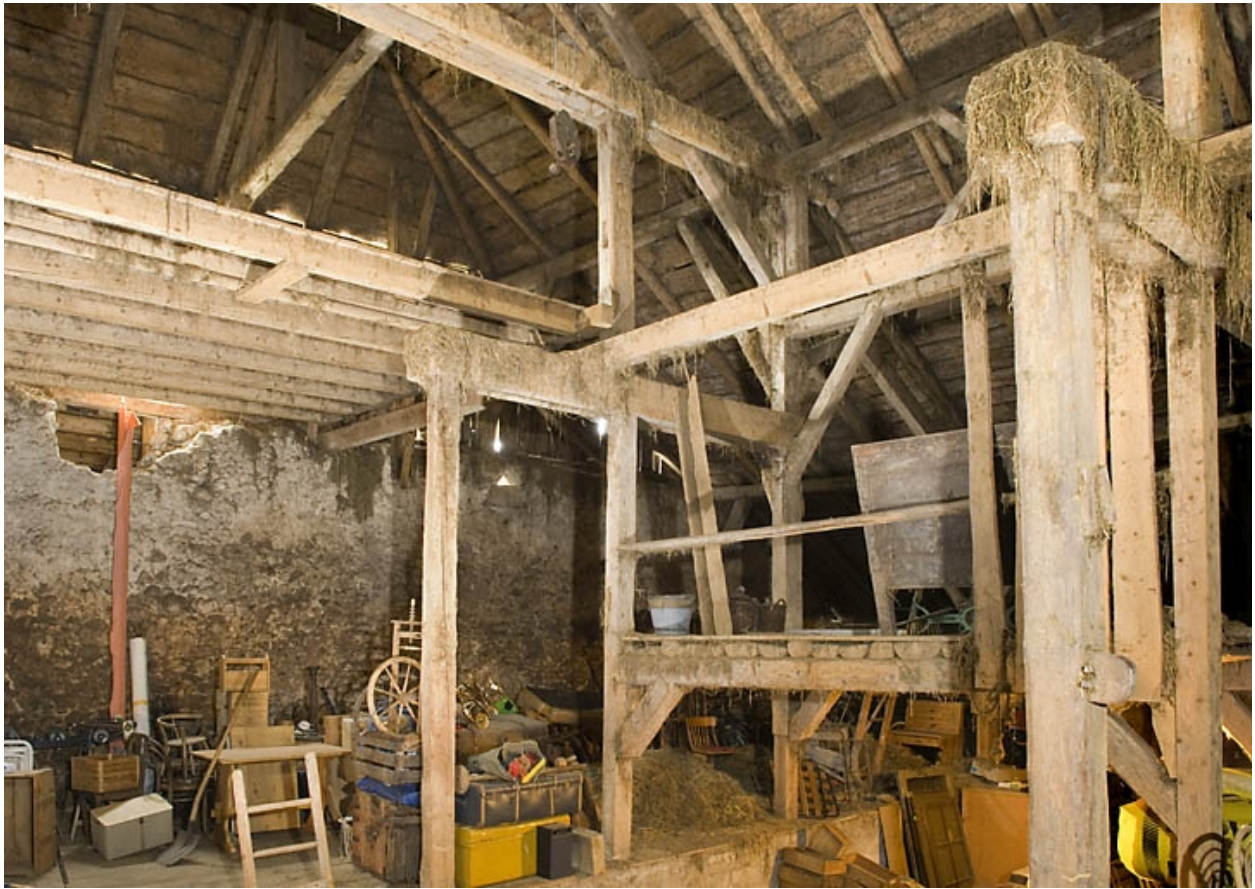
Déchargeuse : charpente et plateforme dans la grange.
