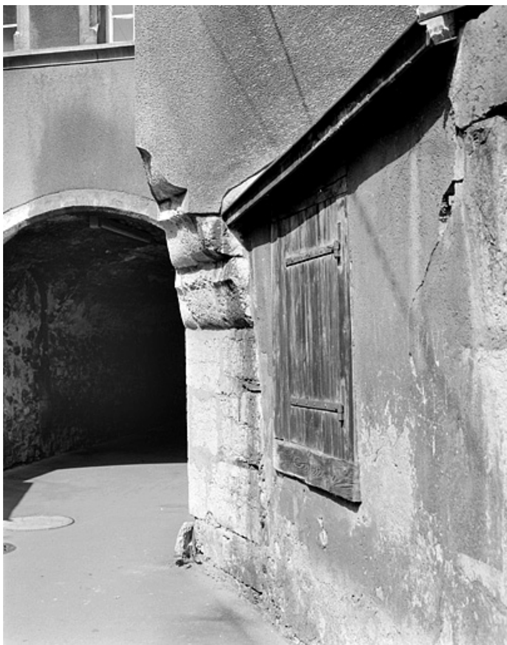
Surplomb de la tour d'escalier.
