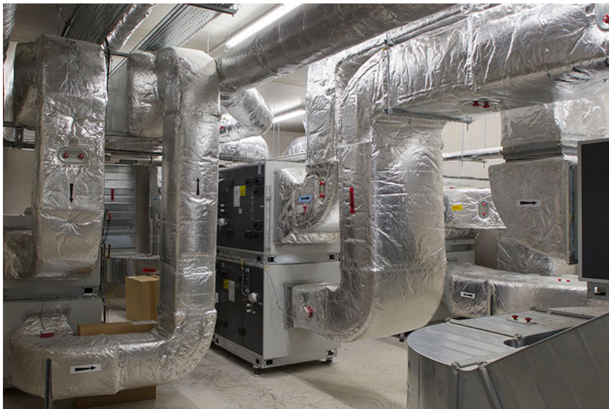
Machinerie d'extraction d'air du p le h telier.
