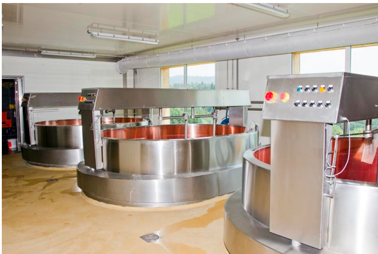
Trois cuves de fabrication.
