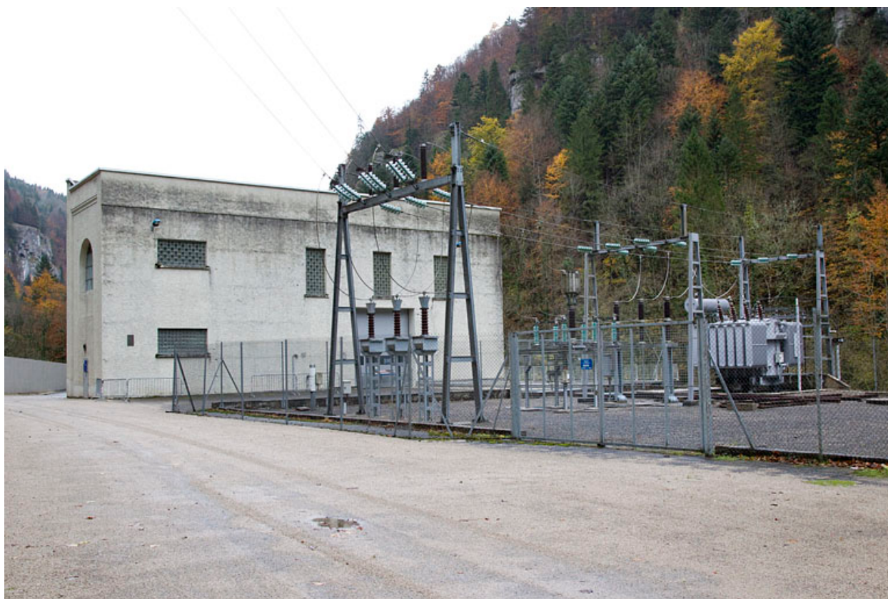
Centrale (façade antérieure) et transformateur.
