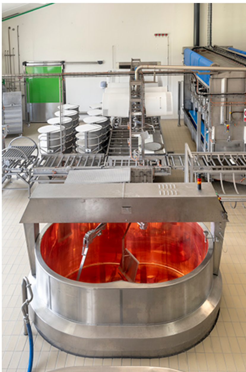
Vue plongeante sur une cuve.
