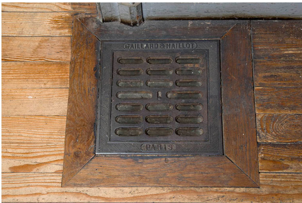
Grille de ventilation du chauffage central.
