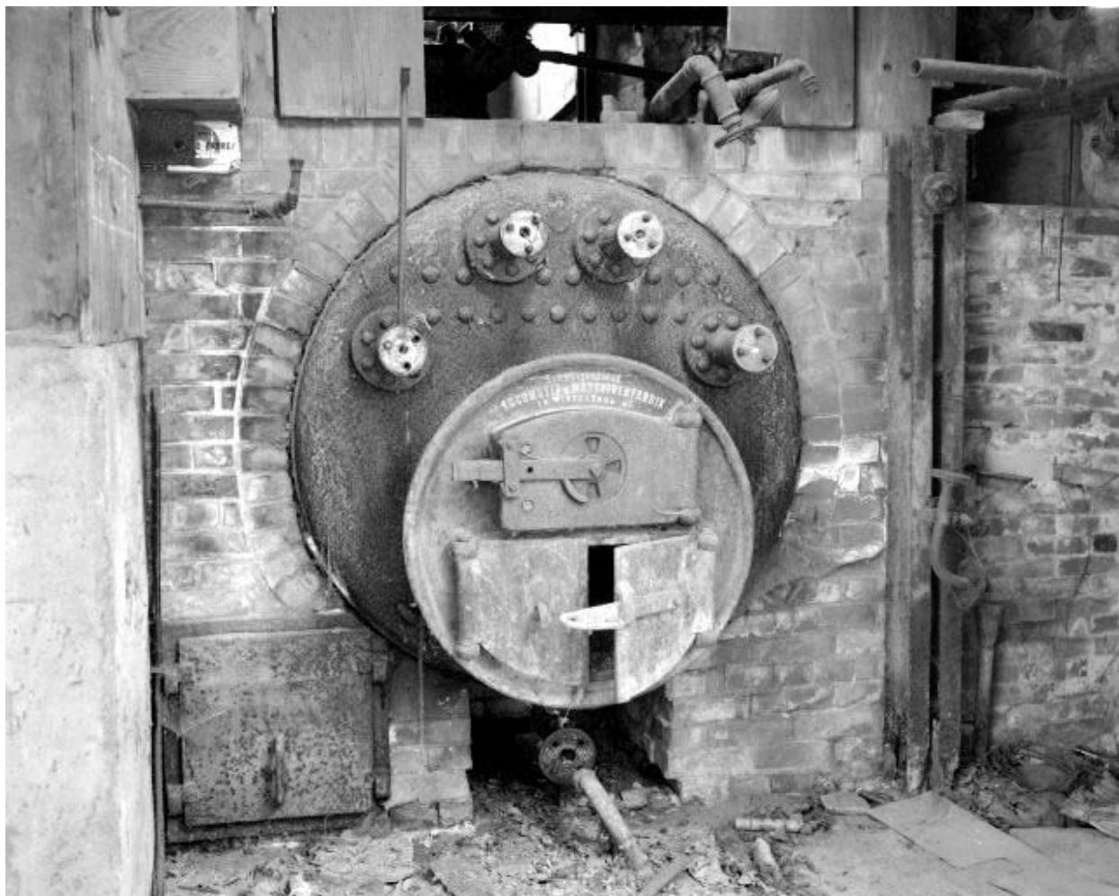
Intérieur de la chaufferie (Q) : chaudière.
