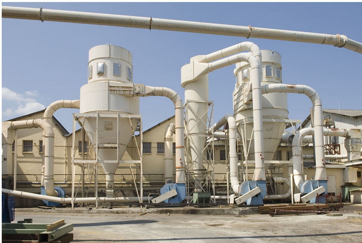
Installation de traitement de la sciure.
